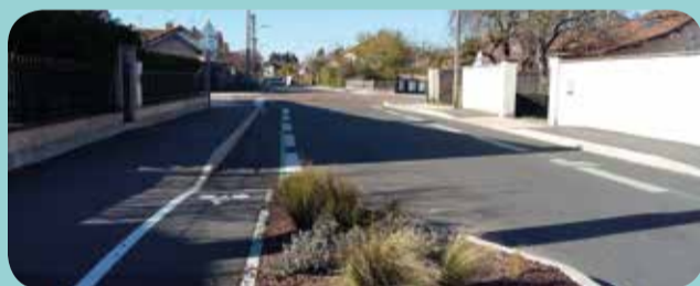
Rue de la Charpine : travaux entièrement de la compétence communale, 1.3 M€ avec apport.
